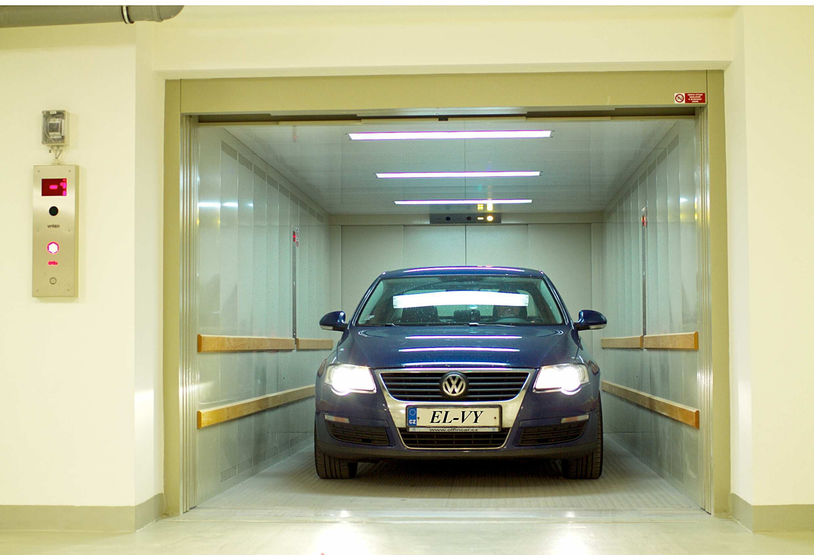
Autovýtah v Bytovém domě Augustýn v ulici Stará v Brně
